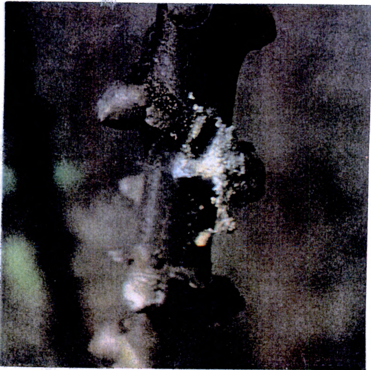
Daño inicial en la estaca
