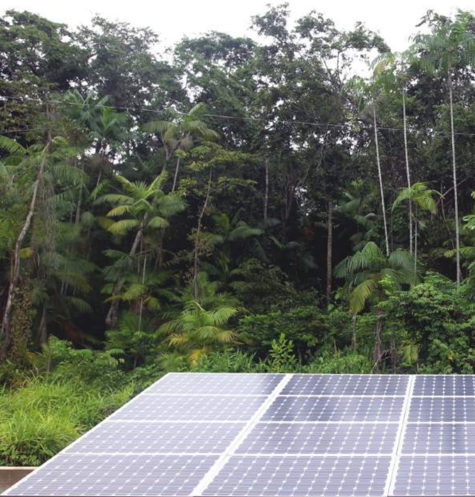
Módulos fotovoltaicos de miniusina . Ilha de Araras . Curralinho . PA Crédito: Bruno Spada
